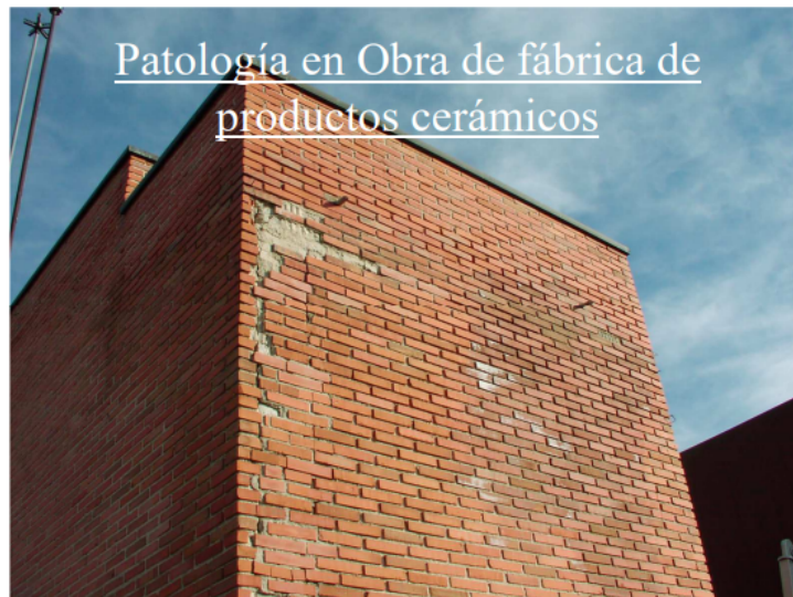
Imagen 15. Patología en obra de fábrica de productos cerámicos
