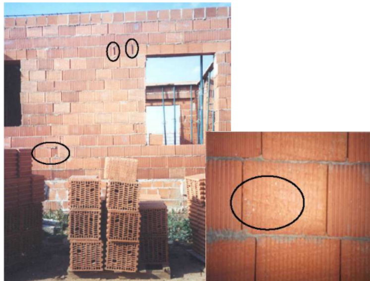
Imagen 17. Defecto en ladrillos
