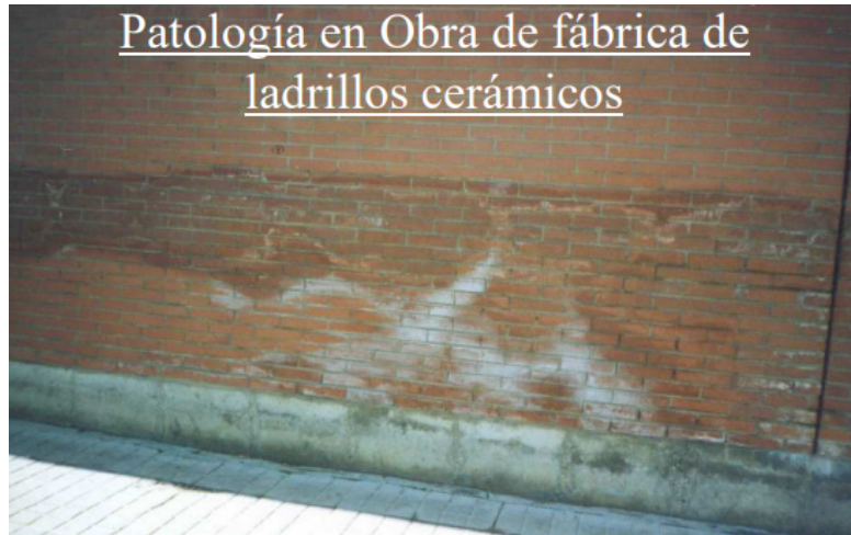
Imagen 16. Patología en Obra de fábrica de ladrillos cerámicos
