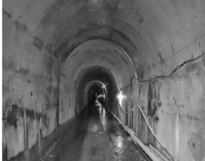
Figura 3. Tunel de suministro.
